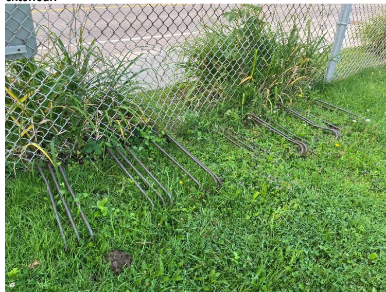
Terrain de jeu de l'école primaire (portion avant), supports à vélos.
